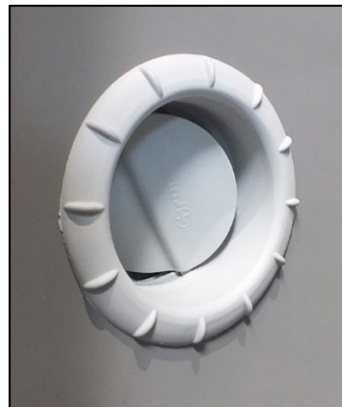
Fig. 105 Sortie (bouches) d'air chaud (exemple)
